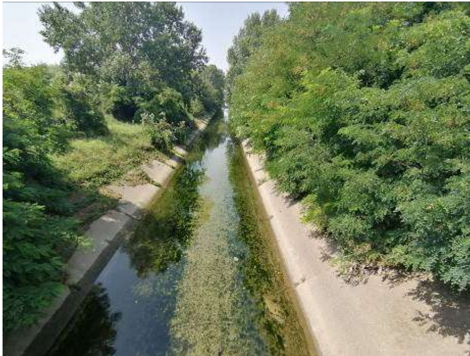
Figura 17. Canale Scolmatore di Nord-Ovest con fitta vegetazione lungo le sponde
